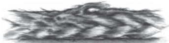
Hilo de cable reducido en un 25% debido a la abrasión: deberá reemplazarse el cable
